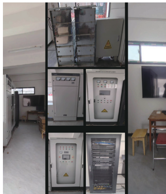
高性能全自动毫秒级异步通讯动态数据采集系统控制室
