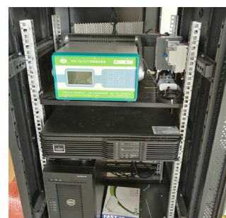
蒸渗仪控制系统
